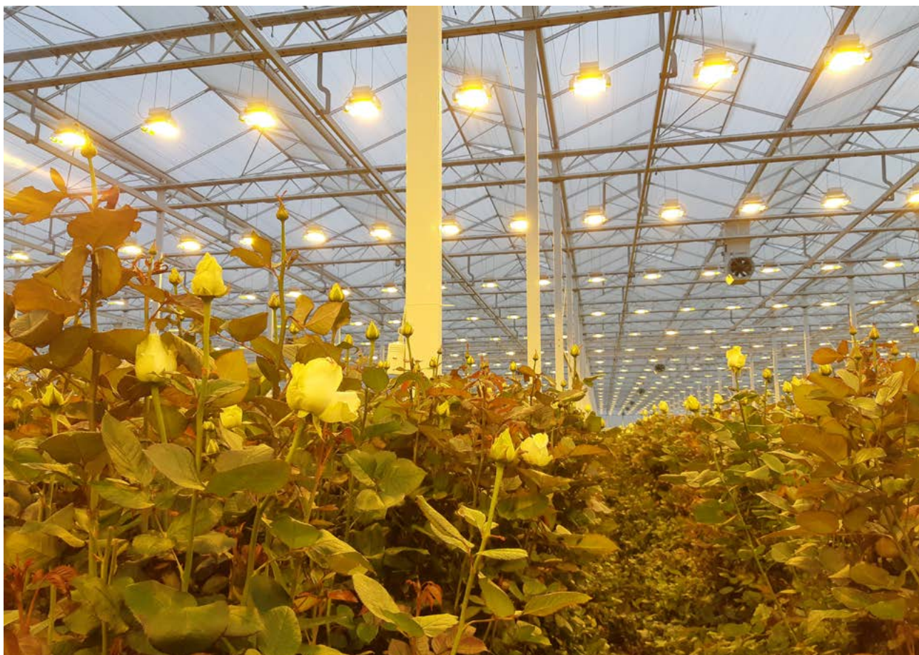
Een schermventilator in de kas verlaagt de luchtvochtigheid rond het gewas, waardoor ziektes minder kans krijgen (foto: WUR).
